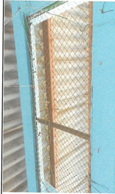
Foto 4: tres aulas del modulo 3 se requiere de colocación de ventanales y los vidrios así como en el modulo 2 necesita cambio de dos vidrios.
